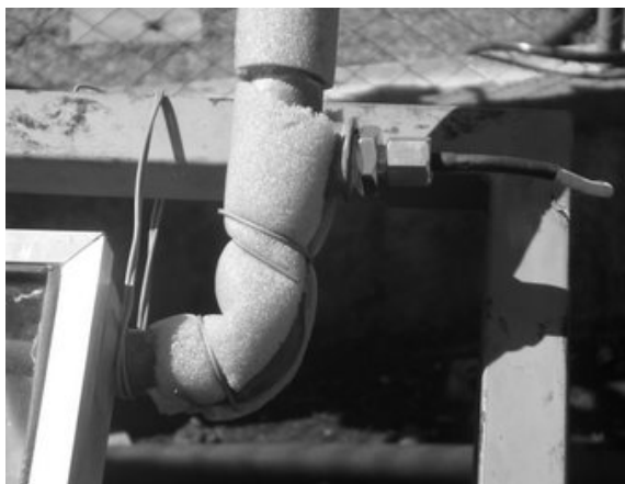
FIGURA 10 – Sensor 3, instalado na tubulação de saída do coletor solar.
