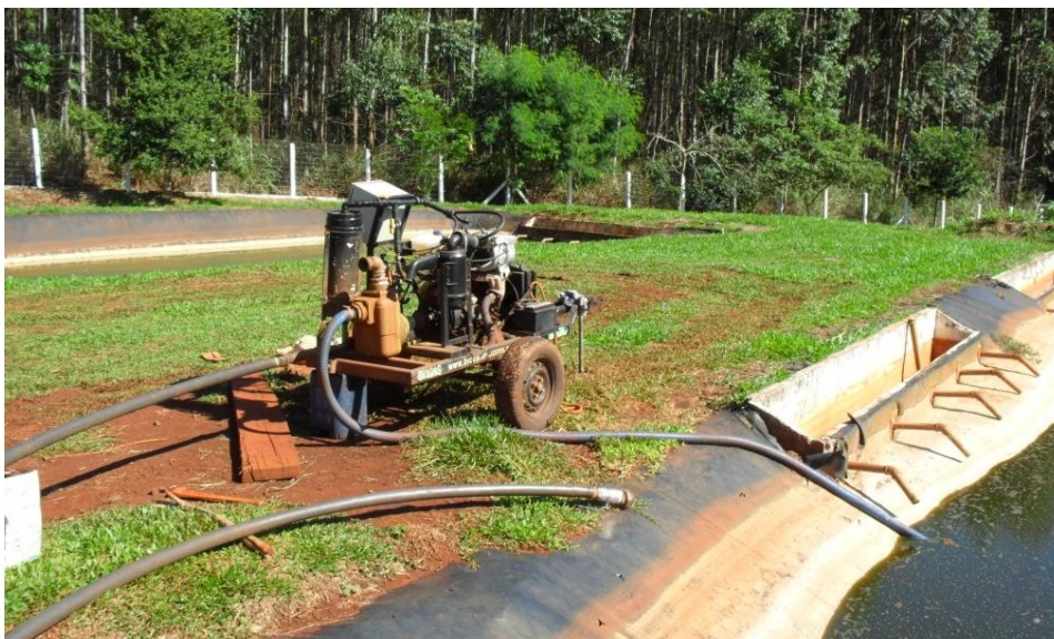
Figura 27 – Moto bomba de recirculação de chorume alimentada a biogás
