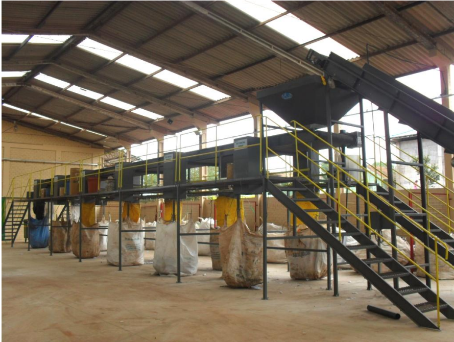
Figura 32 – Esteiras de triagem alimentadas pelo aproveitamento energético do biogás
