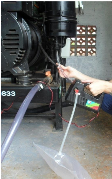
Figura 12 – Ponto 3 de coleta de biogás – Entrada do Gerador
