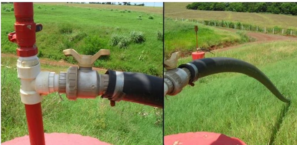
Figura 28 – Canalização do biogás do flare para o sistema de aproveitamento
