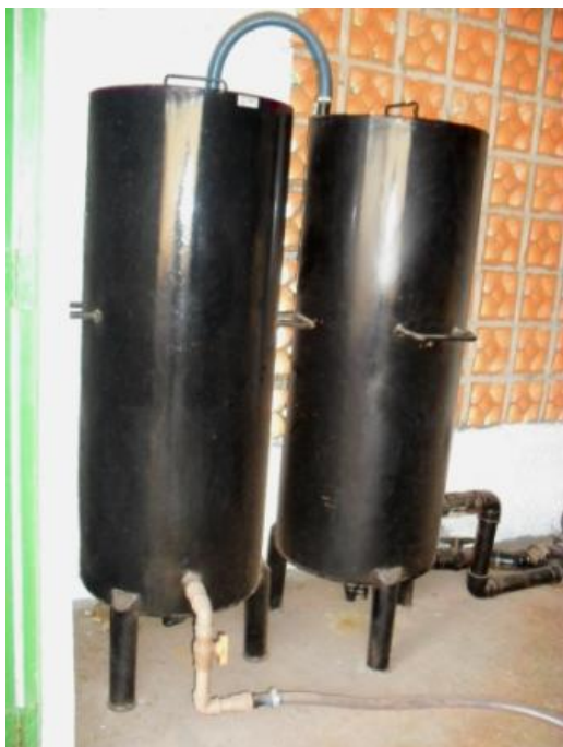
Figura 30 – Filtro para remoção do gás sulfídrico
