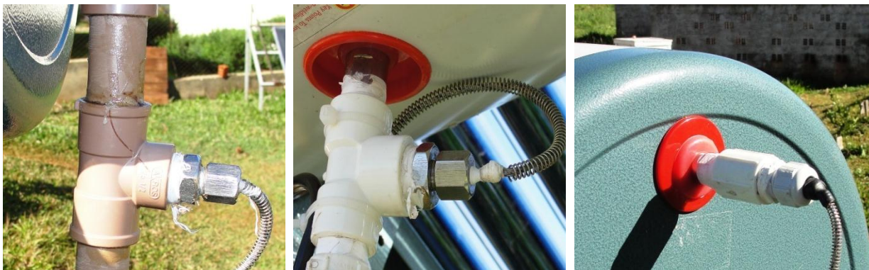
Figura 19: Sensores instalados para medição de temperatura da água. À esquerda, temperatura de entrada da água fria; ao centro, saída de água quente para consumo e à direita, temperatura interna do boiler .
