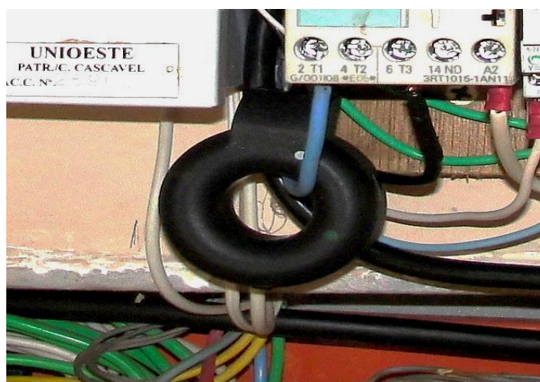
Figura 22: Transformador de corrente tipo janela.
