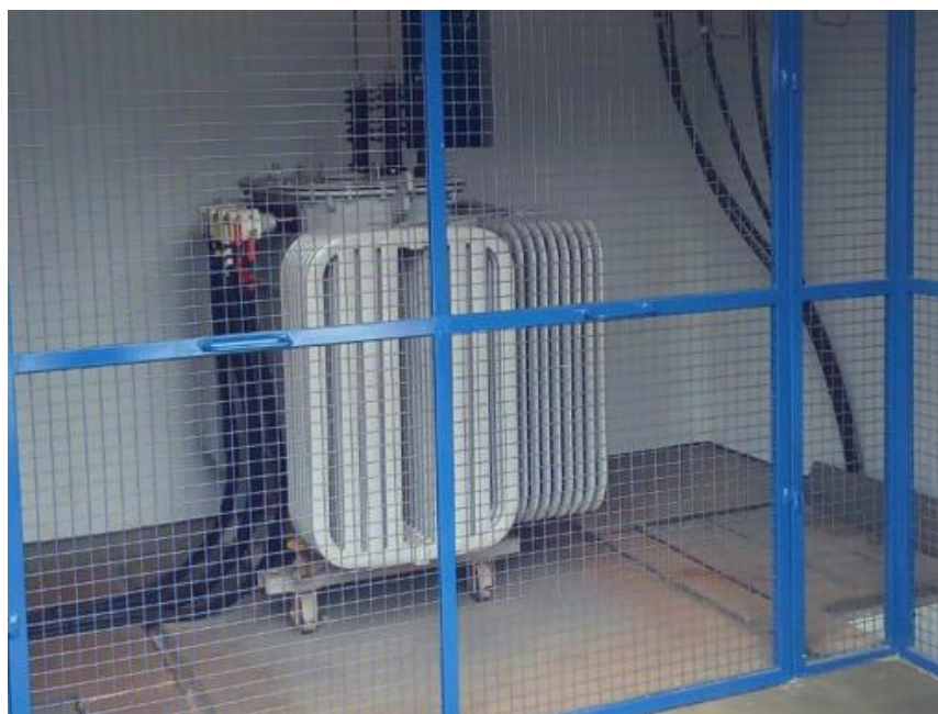
Figura 16 – Transformador de tensão. Fonte: (AUTOR, 2019).
