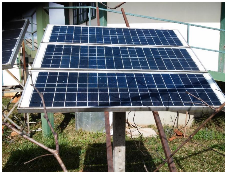
Figura 4: Painel fotovoltaico instalado. Fonte: (Autor, 2016).
