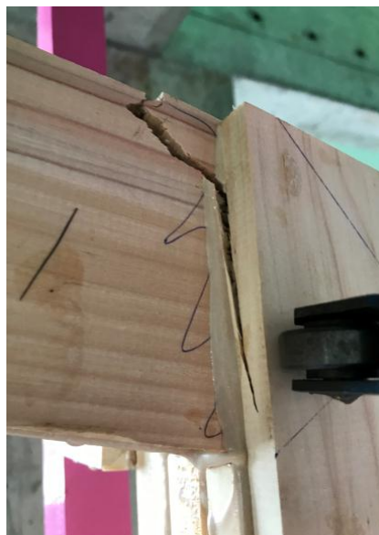
Figura 21 – Detalhe de ruptura do pórtico 4, nó E.
