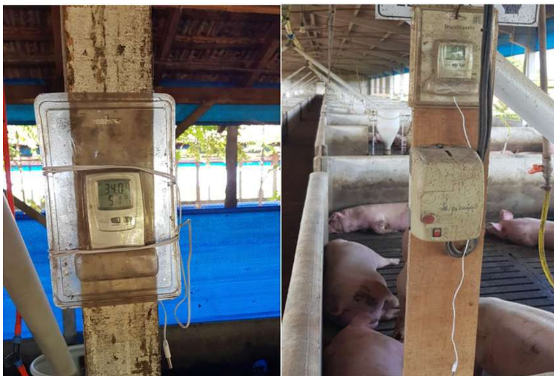
Figura 24 - Exemplo da instalação dos termo-higrômetros digitais nas pocilgas.
