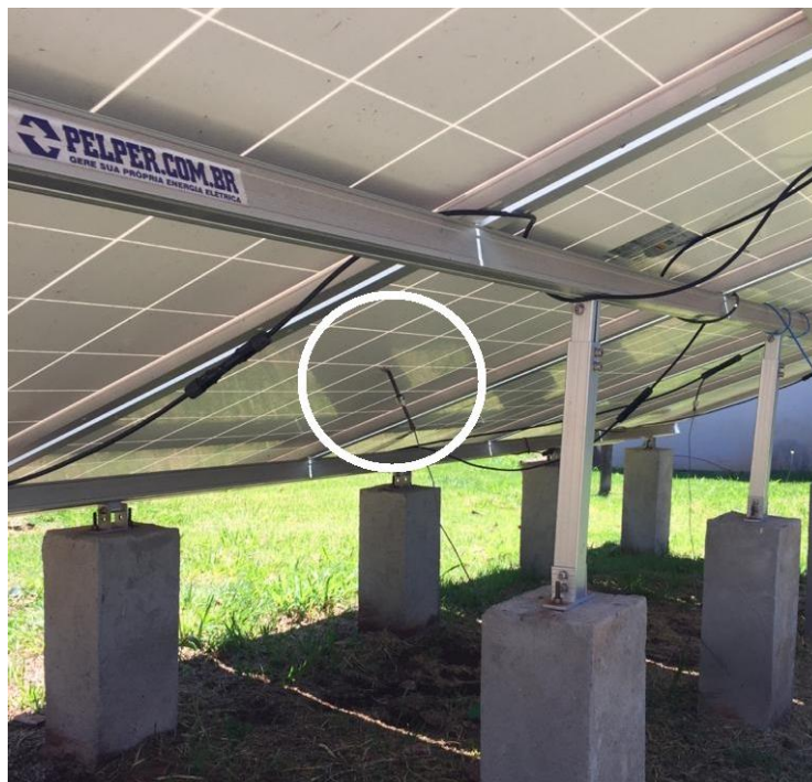
Figura 26 - Localização dos termopares tipo J nos módulos fotovoltaicos.
