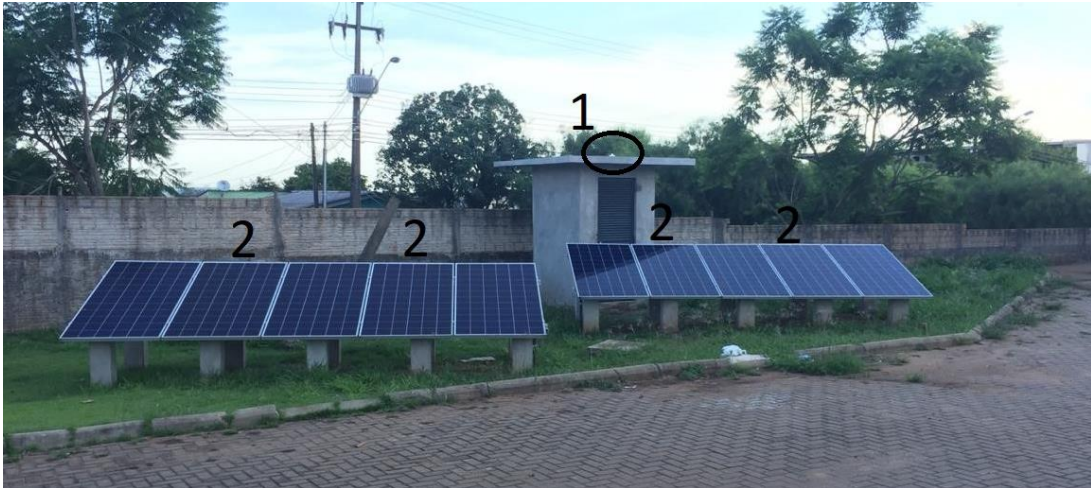
Figura 18 - Sistema fotovoltaico instalado na UNIOESTE, Campus de Cascavel. 1- Localização do Piranômetro CMP3; 2- Módulos fotovoltaicos que foram registradas as temperaturas.
