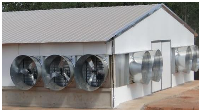
Figura 19- Exaustores de pressão negativa em dark house Fonte: engormix, 2014.
